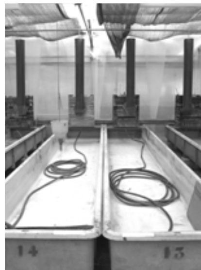
Photo 4: Auges d'alevinage en circuit ouvert avec tour de dégazage et tuyau échangeur de chaleur
